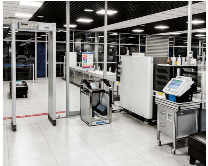
Ispezione dei passeggeri mediante metal detector a transito [WTMD], analizzatore di scarpe [SAMDEX] ed ispezione corporale mediante rivelatore di tracce di esplosivo [ETD]
